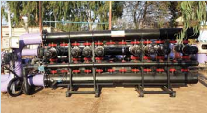
מערכת סינון למים מושבים כ-350 מק"ש עם אפשרות להגדלת הספיקה ל-500 מק"ש גד"ש בית אלפא
