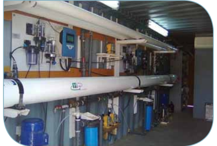
איור 3 - מתקן התפלה ניר עציין, כ-10 מטר מעוקב לשעה: מערכת אוסמוזה הפוכה דו שלבית
